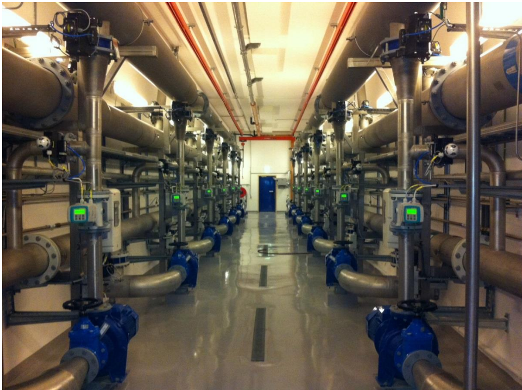
Figur 10 Rosse vannbehandlingsanlegg, rørgalleri.
