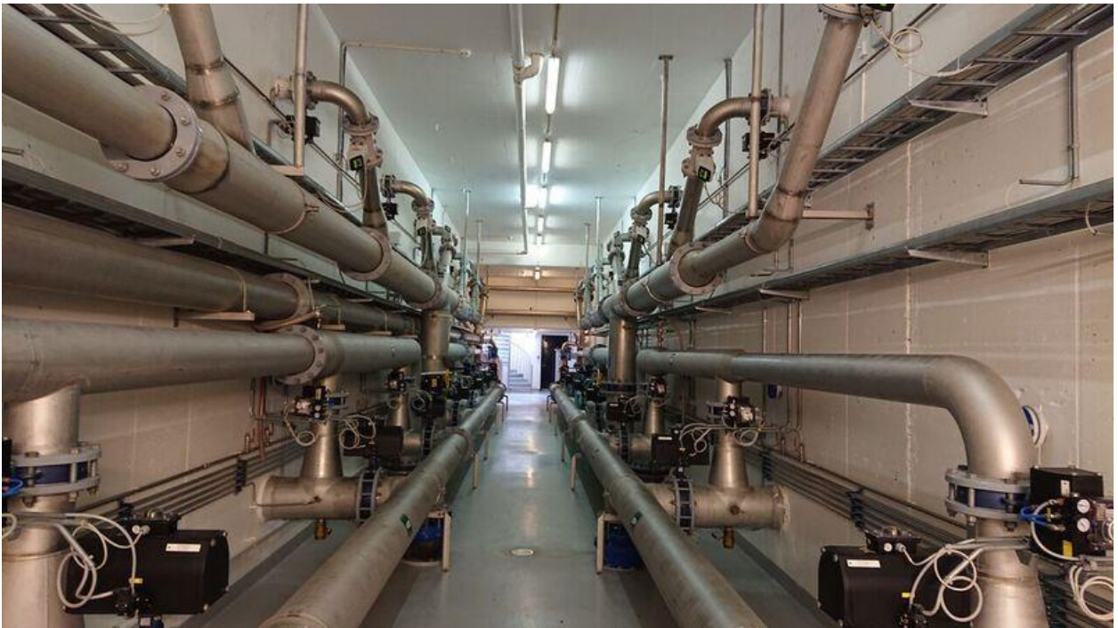
Figur 13 Tronstadvann vannbehandlingsanlegg, rørgalleri.
