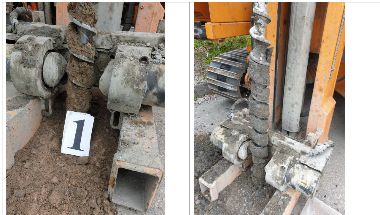
Bilde 1 viser prøvepunkt BP1 dybde 1 meter (til venstre) og dybde 4 m (til høyre)
