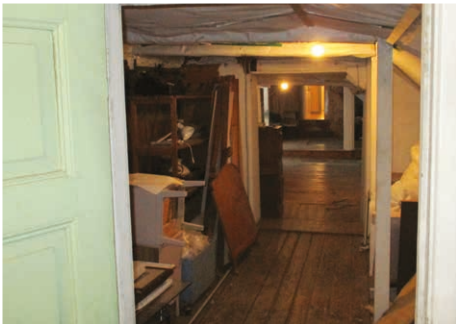
Over: Dette loftet binder tre gamle trehus sammen. I slike tilfeller bør det installeres brannsperrer og brannører slik at en brann ikke kan spre seg fra hus til hus.
