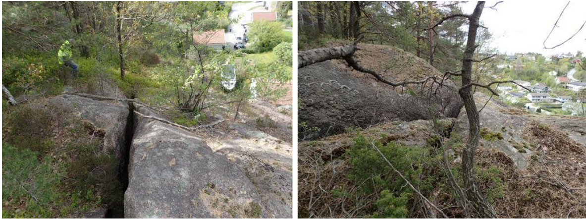
Figur 4. Sprekk i bakkant av skrenten.
