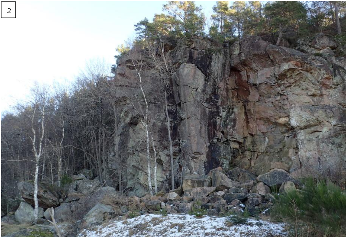
Figur 15. Berghammer ved punkt 2 i registreringskartet. Deler er tatt ned kontrollert tidligere, men rapport fra 2020 konkluderer med at det er behov for ytterligere tiltak i dette området. Stor rasfare i området er vist i faresonekartet.
